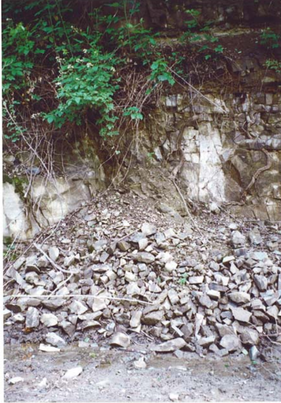
شکل ( ۶ ) شیب واریزه‌ای حاصل از تخریب بلوکی
